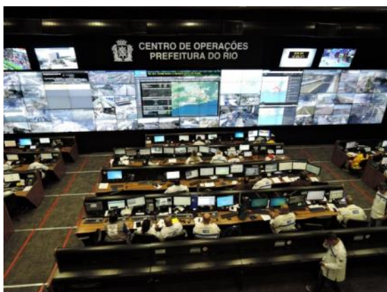
<オペレーションルーム>
